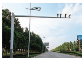
库车县平安城市 视频监控系统二期工程
